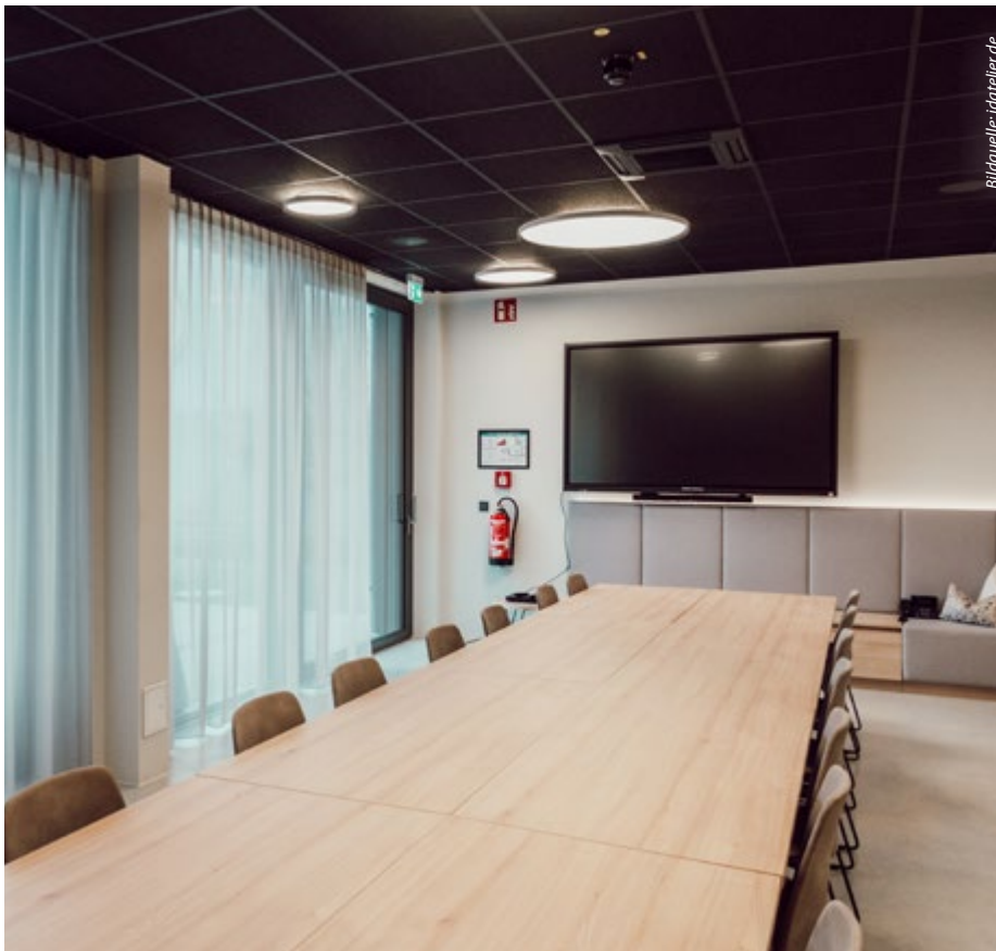
Panasonic ECOi Kassettengeräte mit Sonderlackierung fügen sich harmonisch in das Gesamtkonzept ein
