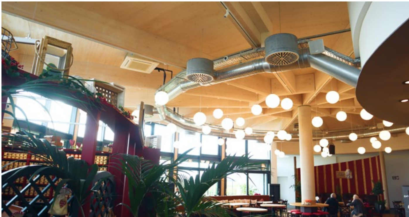
Das lichtdurchflutete Bistro der Metzgerei Weinbuch wird mit effizienter VRF-3-Leiter-Technik von Panasonic klimatisiert
