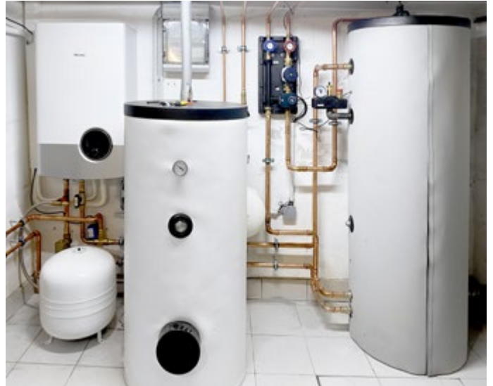
Inneneinheit, Trinkwasser- und Pufferspeicher, Ausdehnungsgefäße und die dazugehörige Mischergruppe wurden nach der VDI 4645 ausgelegt
