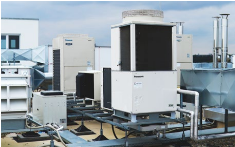
Auf dem Gebäudedach installierte CO 2 - und VRF-Außeneinheiten
