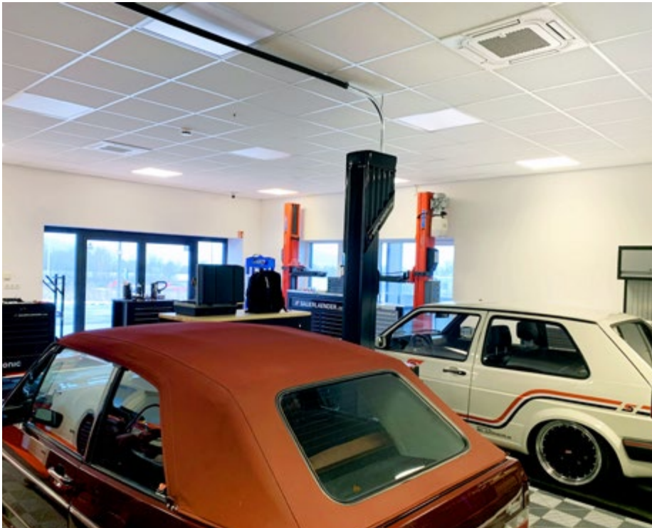
Die in der Odenwaldecke installierten Eurorastermaß-Kassettengeräte von Hisense sorgen für optimale Raumtemperaturen.
