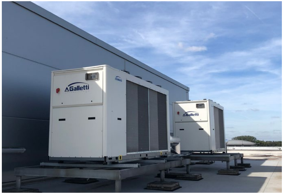
Galletti-Außeneinheiten auf dem Dach eines der Bürotürme
